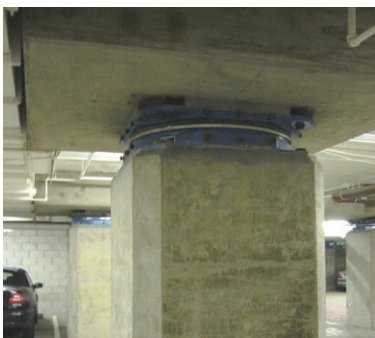
写真2 地下駐車場の免震装置
