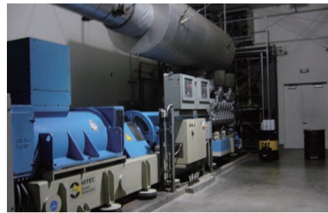
写真3 フライホイールを使用した非常用電源
