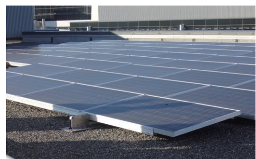
写真4 設置傾斜角の小さいソーラーパネル
